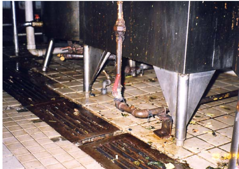
Gambar 15: Keadaan lantai dapur yang kotor
